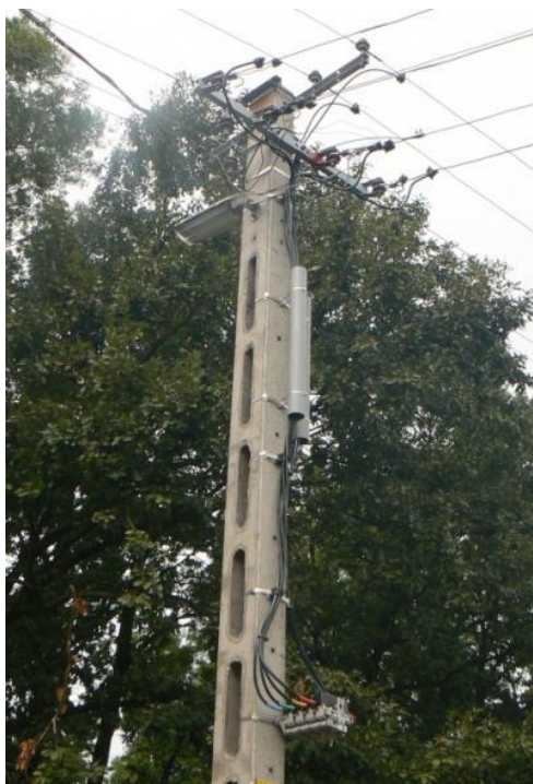
5. Kép KIF leszálló vezeték és oszlopkapcsoló
